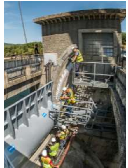
Protecciones colectivas mediante andamio homologado.
