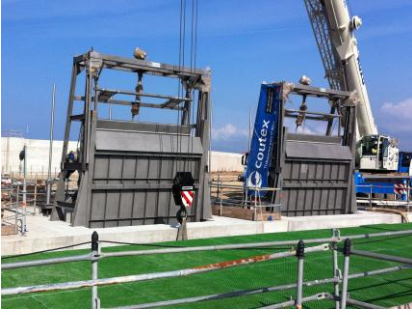
Vista de las dos rejas de cable instaladas.
