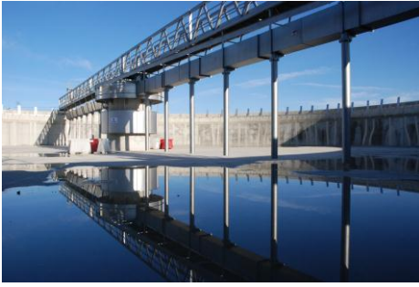
Vista de los tubos de succión.
