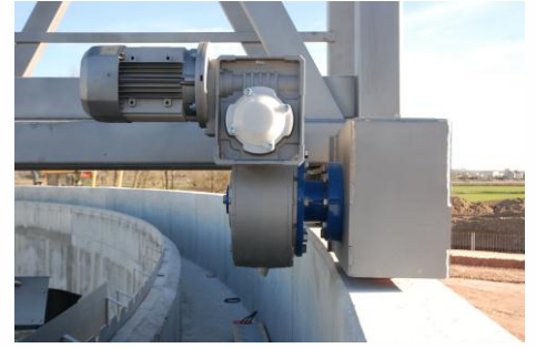
Carro motriz del puente decantador de succión.
