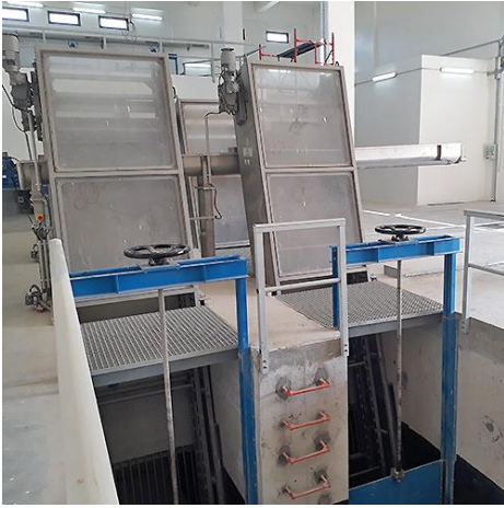
Rejas de limpieza automática y compuertas de toma.
