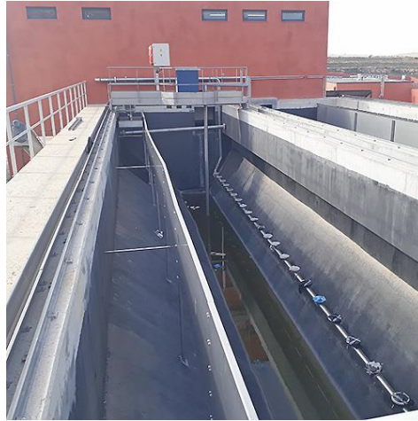
Vista del puente desarenador-desengrasador.
