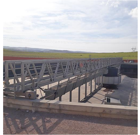
Vista de unos de los puentes decantadores de succión.
