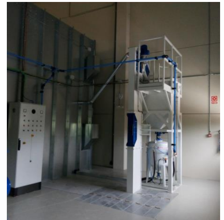
Vista interior nave. Zona cuadro eléctrico e instalaciones equipos auxiliares cabinas.
