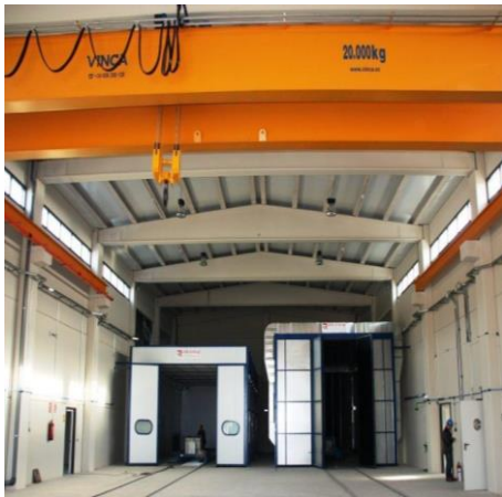
Vista interior nave. Puente grúa y cabinas granallado y pintura.
