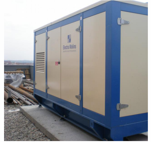
Grupo electrógeno edificio de Biomedicina en el Campus Ciències de la Salut.
