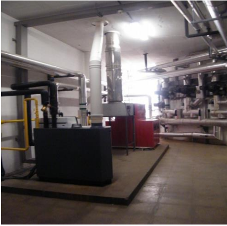
Sala de calderas edificio EPS en el Campus de Cappont.
