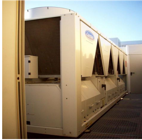
Planta enfriadora zona biblioteca edificio Rectorat.
