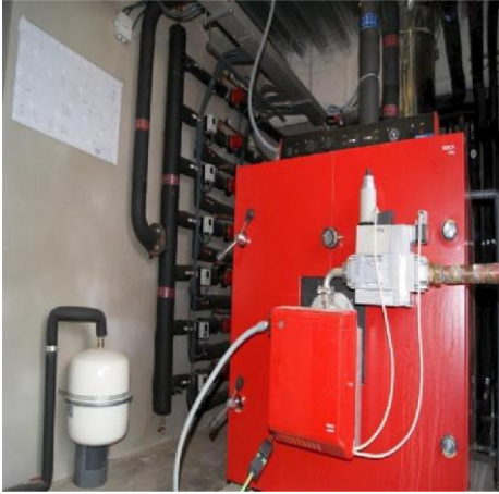
Sala de producció de calefacció.
