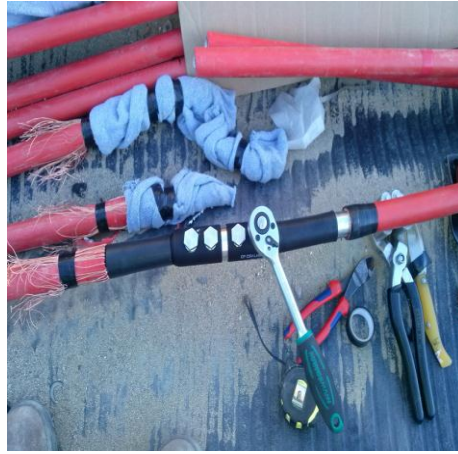
Empalme Unipolar termorretráctil de cable de media tensión.
