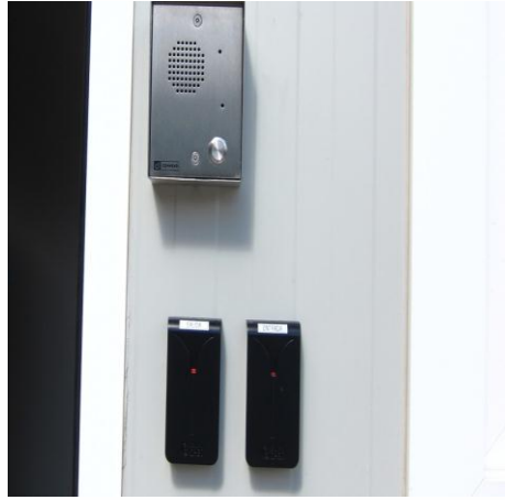
Control de acceso.
