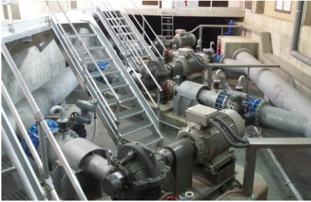
Estación de bombeo general (EBG).
