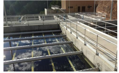
Vista general de los decantadores y filtros de la ETAP.
