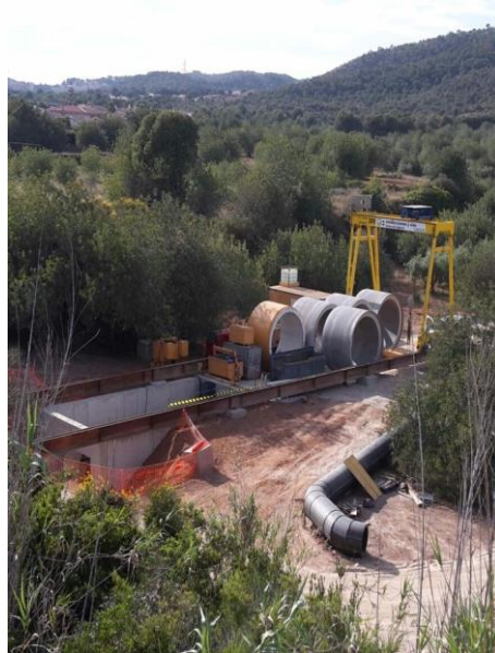
Hinca de tubo DN3000 para paso de vía de FFCC. Vista general pozo de ataque.
