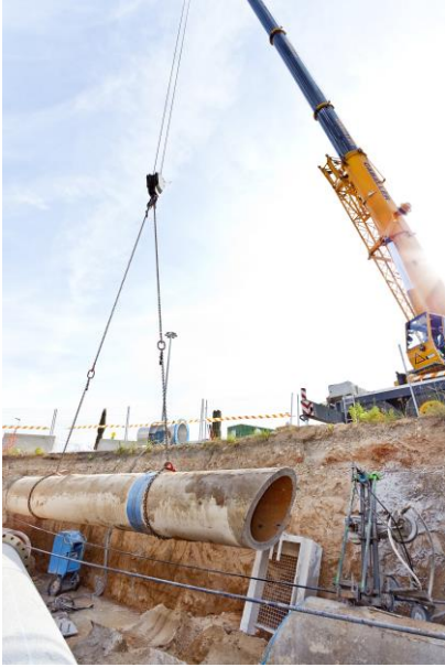
Trabajos de corte y retirada de tubo existente en zona de conexión de la nueva tubería.
