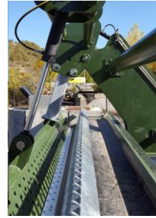
Vista de la cinta transportadora.
